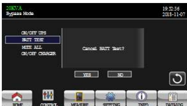
Отменить испытание батареи
